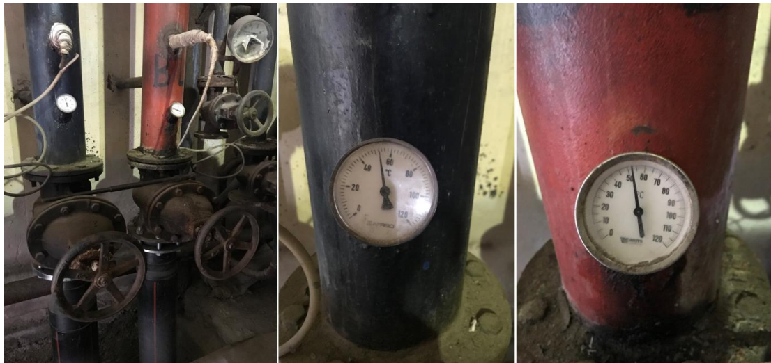
Ilustrația 13: centrala de încălzire cu conductă de alimentare și flux de retur (tranziția de la metal la plastic-HDPE)
