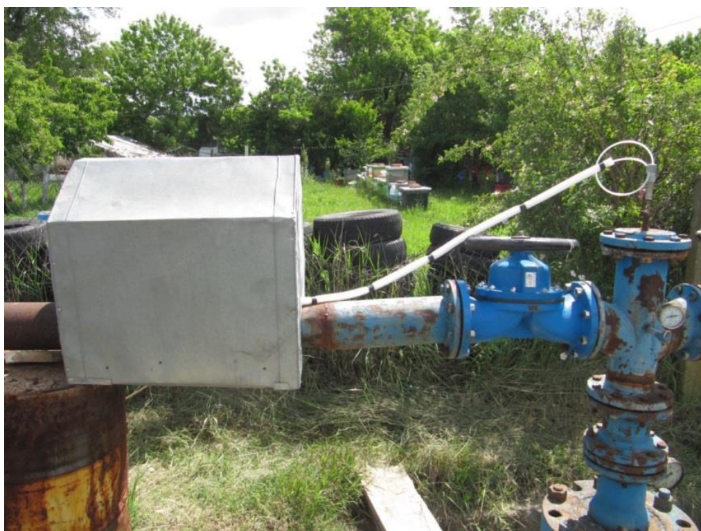
Ilustrația 25 : dispozitiv instalat deja pentru injectarea inhibitorului în puțul de producție 4167 în Lovrin.
